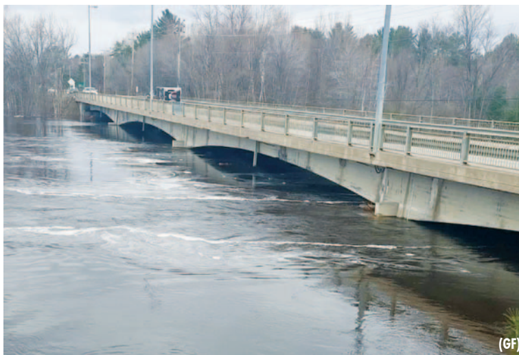
L'eau en crue sous le pont Blanc à Mansfield. (GF)
